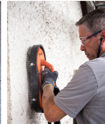
Haftwurzeln an Fassade entfernen
